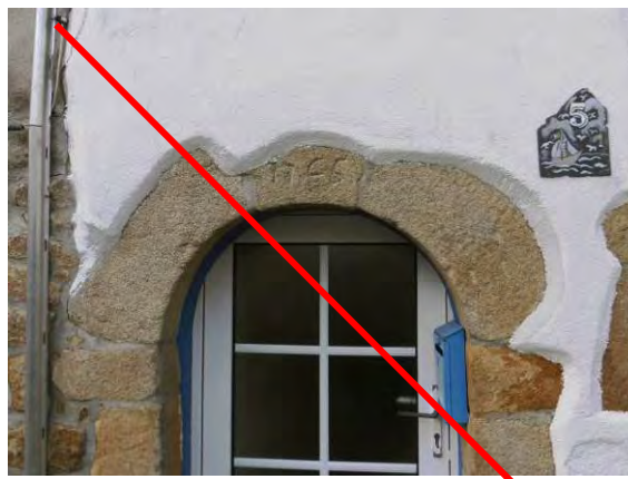
Ci-contre, l'enduit a été appliqué en épaisseur et présente un fort relief par rapport au nu de la pierre apparente. NON
