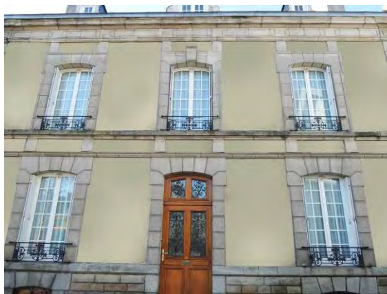
APRES : mise en valeur de la pierre de taille noble des encadrements, des bandeaux et du soubassement : OUI (simulation)
